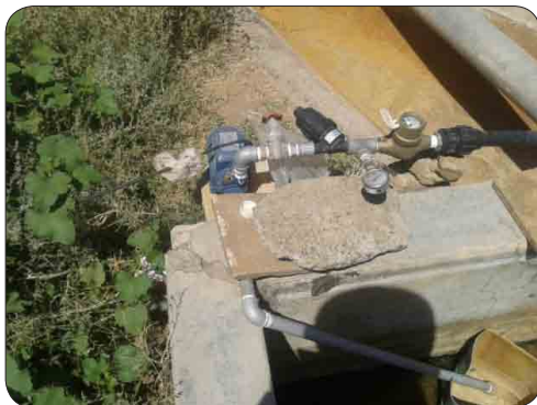
شکل ۴: تجهیزات اسیدشویی سامانه آبیاری قطره‌ای
