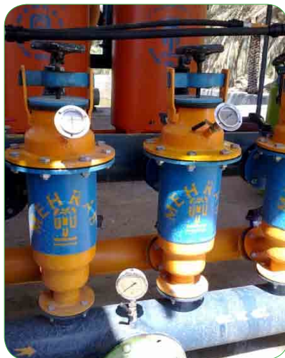
شکل ۷: محل نصب فشارسنج‌ها برای کنترل
